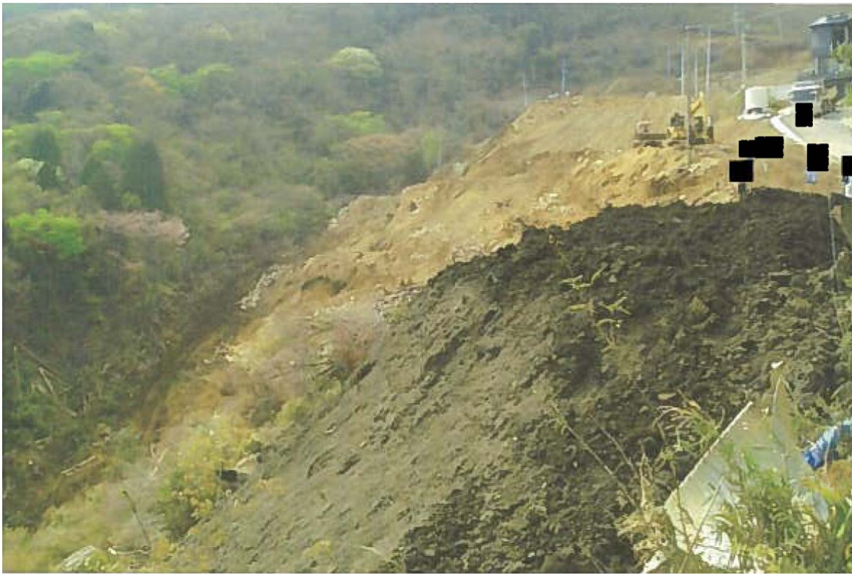
熱海市の盛土現場。急斜面で、危険なことがこの写真からもわかる (熱海市のホームページ)
